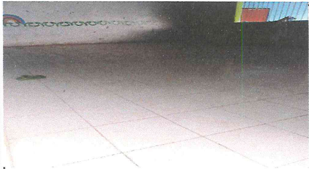
Foto 3: SUSTITUCIÓN DE TORTA DE CONCRETO POR PISO CERAMICO EN SALON DE CLASES
